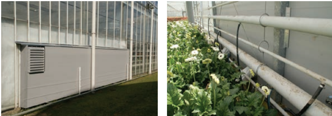
Figuur 6.5. FCA geplaatst in de gevel van een gerberabedrijf.
