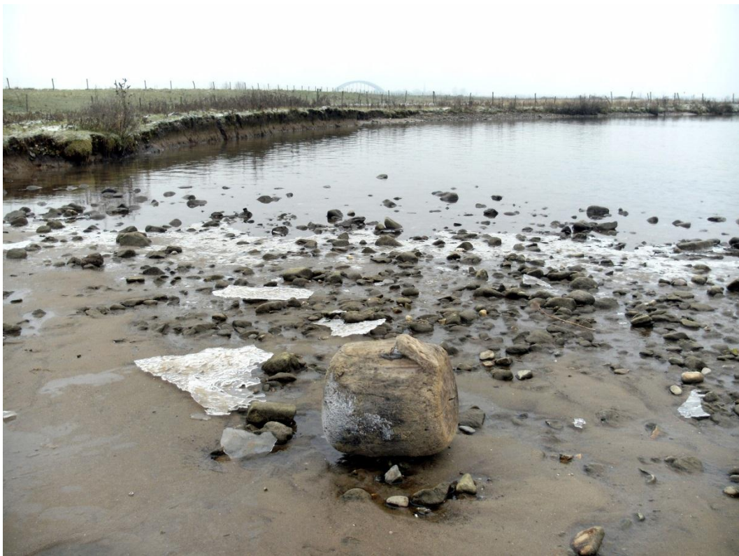
Figuur 4.9 Oevererosie in een met grof grind en keien verdedigd kribvak langs de Steenwaard.
