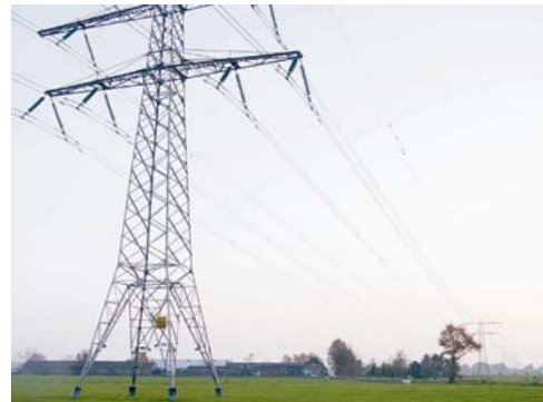
Foto 46 Hoogspanningsleiding, in het open gebied zeer zichtbaar (nutsvoorzieningen).
