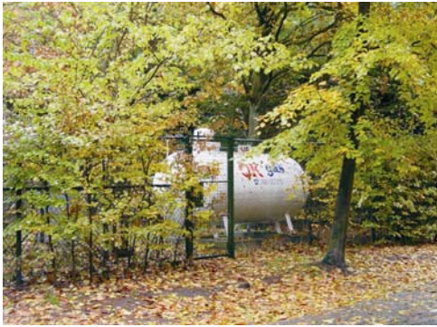
Foto 25 Bovengrondse opslag tank, min of meer weggemoffeld (nutsvoorzieningen).
