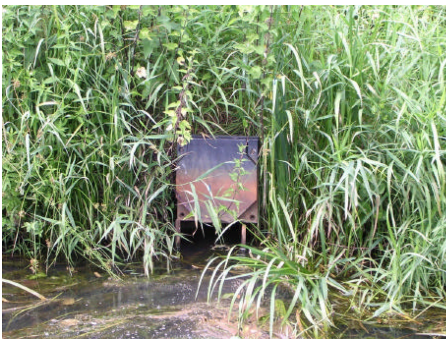
Figuur 8. 2. Juli 2003. Zo hoort het: het peil van de beek is lager dan de afvoerbuis, waardoor wateraflaat vanuit het Koelbroek plaats kan vinden.
