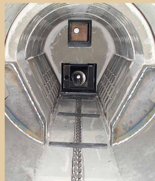
Kanaal van de biomassaketel.
