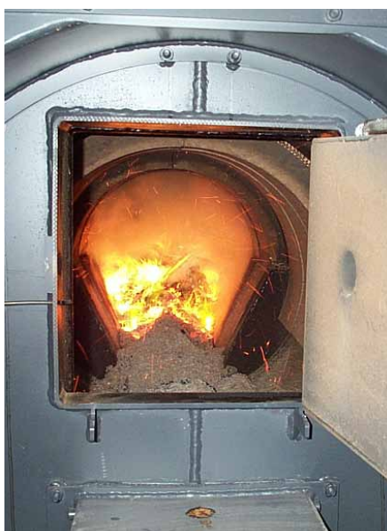
De houtketel heeft periodiek onderhoud nodig, zodat deze efficiënt blijft stoken.
