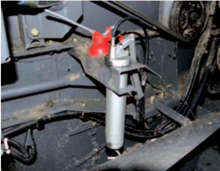
▲ Een vetspuit en oliekan zijn netjes opgeborgen. Ook zit er op de machine een afsluitbare kast. Handig om reserveonderdelen in te bewaren.
