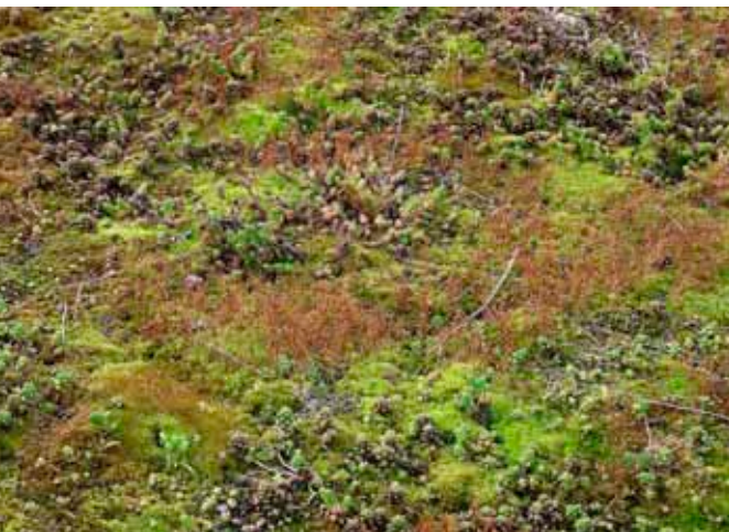
Mosvorming op te nat dak
