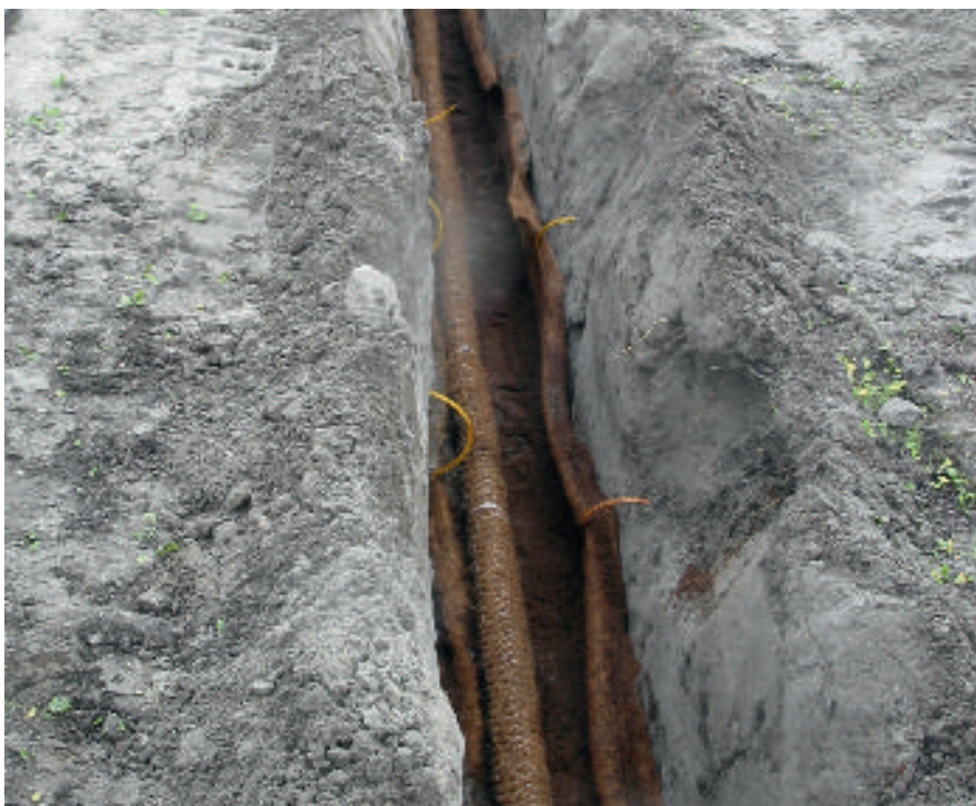
De aanleg van de met ijzerzand omhulde drainagebuis op een bloembollenperceel nabij Egmond aan den Hoef.
