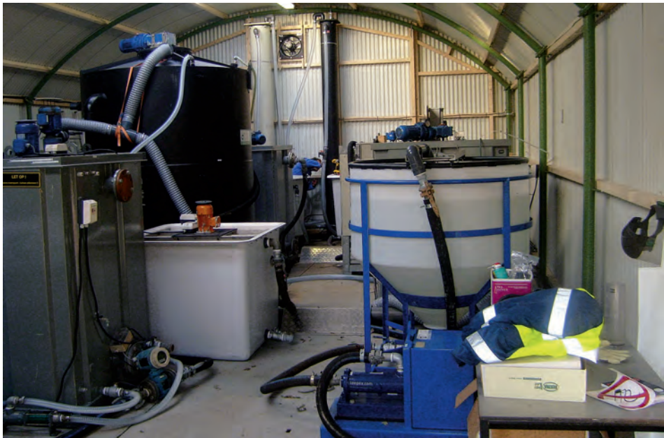
De pilot-installatie op de rwzi Scheemda.
