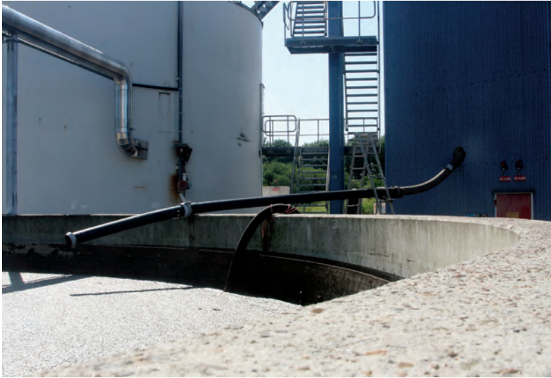
De proviso- rische recir- culatie en overstort.
