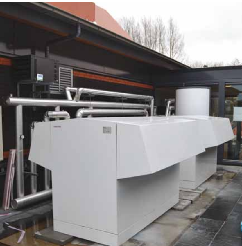
Een warmtepomp brengt het water voor de vloerverwarming op een temperatuur van circa 25 – 30 graden Celsius.
