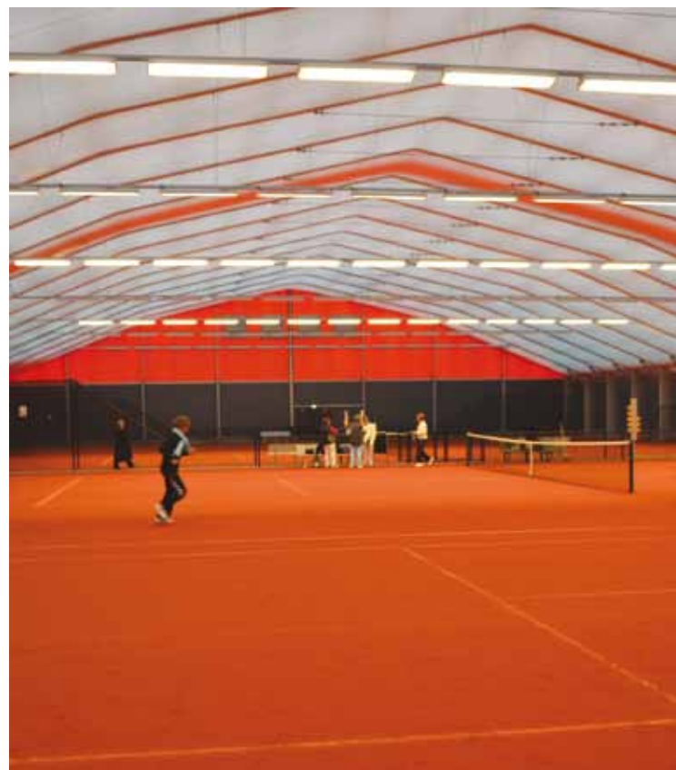
De toevoerkleppen voor frisse lucht in de gevel. In de gevel aan de overzijde bevinden zich ventilatoren.
