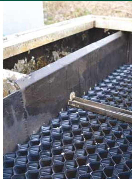
Beluchting: het te reinigen water in de tank wordt actief rondgepompt, belucht en in aanraking gebracht met bacteriën.
