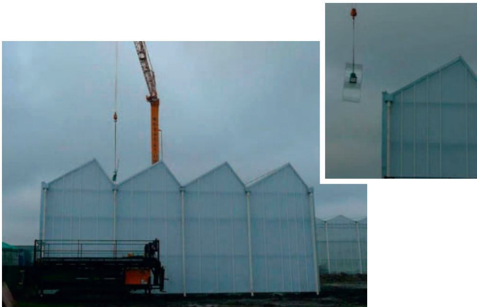
Figuur 3.6. Januari 2011. De glasplaten waartussen de lenzen zitten worden met een kraan in de zuidwaarts gerichte dakvlakken gehesen.
