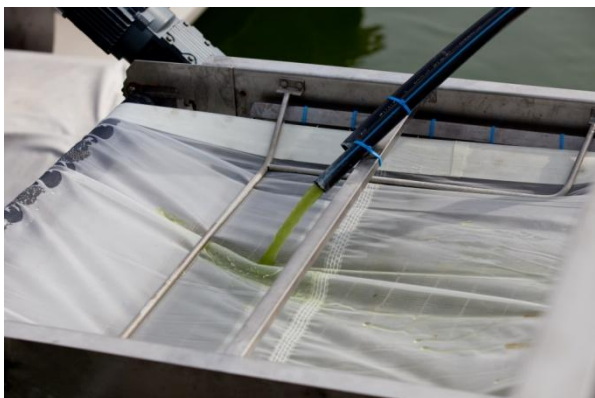
Figuur 16: doekfilter in gebruik om het algenwater en de voeding te filteren
