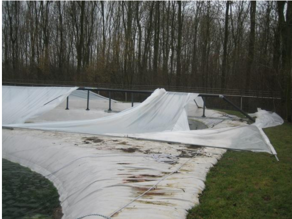
Figuur 15: stormschade aan de overkapping, februari 2011
