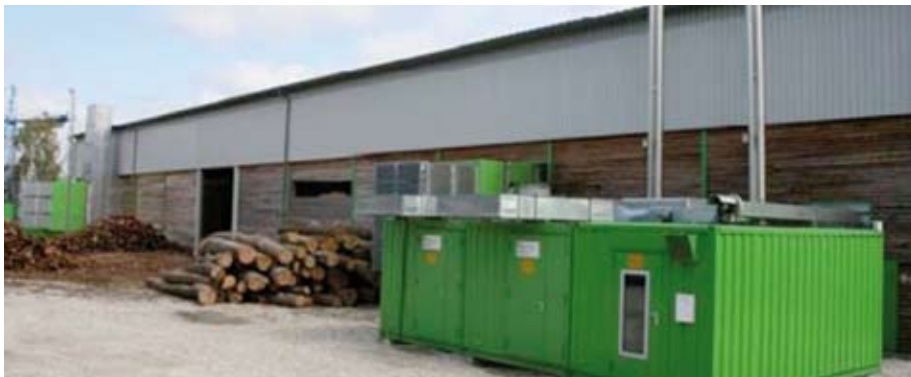
Foto 5: DB-technologies met vergassingsinstallatie en dieselmotor buiten opgesteld.
