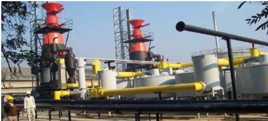
Foto 3: Opstelling van Ankur vergasser-WKK-installatie in India.
