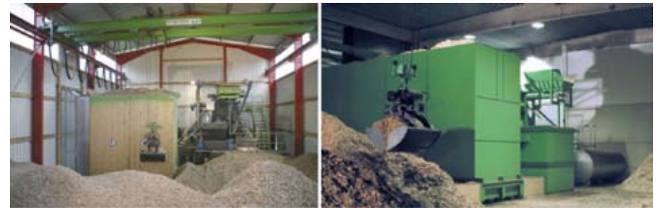
Foto 6: DB-technologies volledig automatische brandstoftoevoer.
