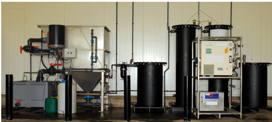
Figuur 2-5: Gerealiseerde installatie. Van links naar rechts slibbezinkbak en lamellenseparator (bestaand), in line filter 50-75 µm, eerste actiefkoolfilter, eerste ozonreactor, ozongenerator met daarachter de tweede ozonreactor, tweede actiefkoolfilter.
