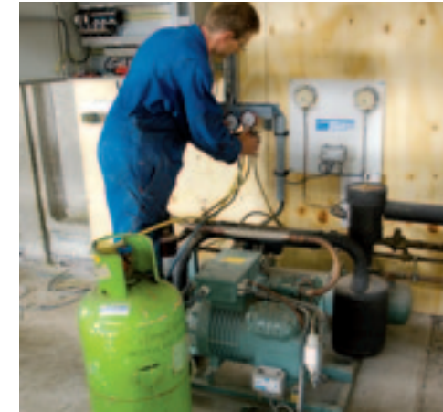
▲ Het navullen met eerder gebruikte R22 is in 2015 niet meer toegestaan.
