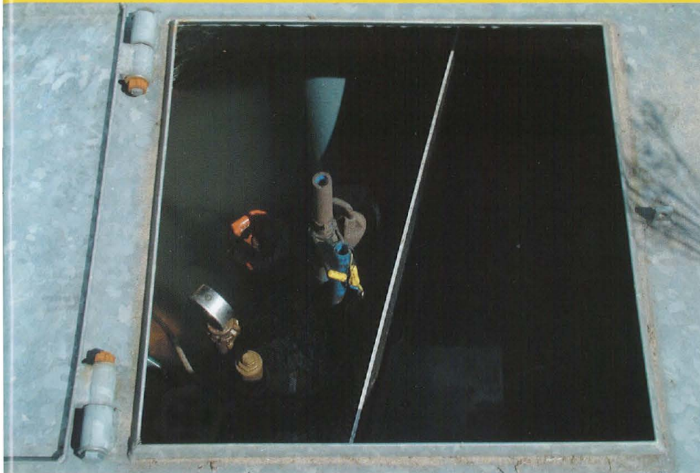
De put waarin het water wordt opgepompt.
