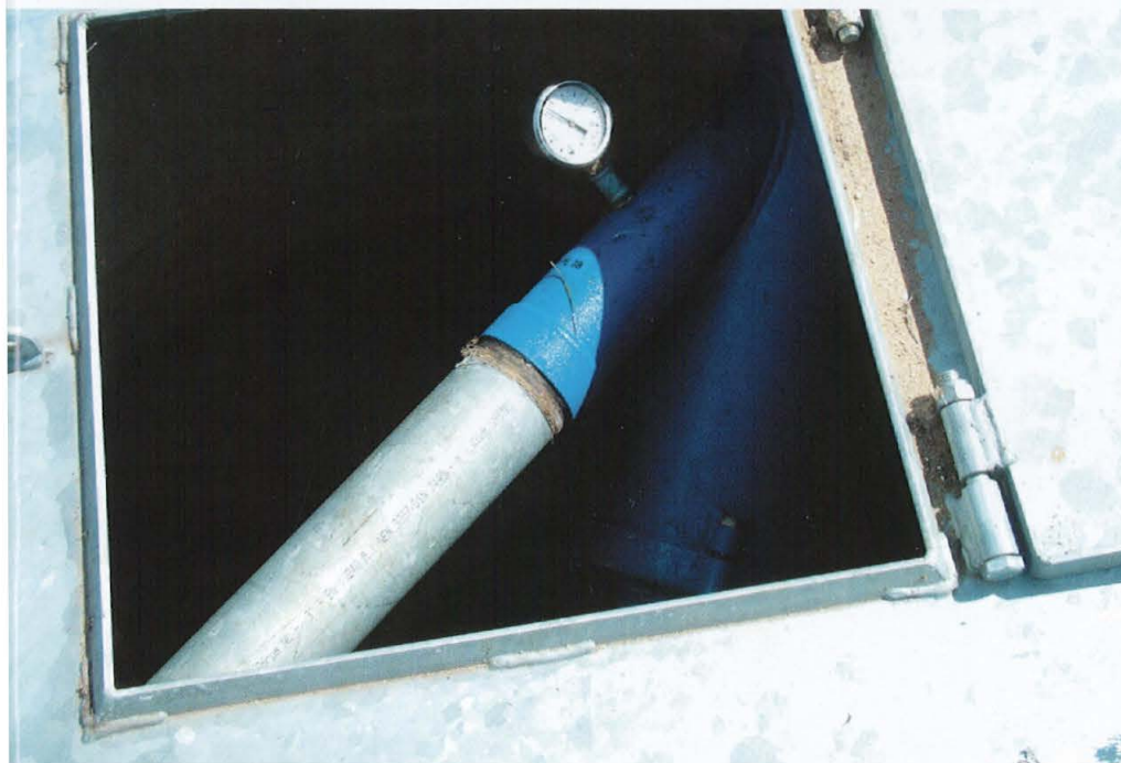
De put waarin het opgepompte water wordt gefilterd voordat het in het systeem wordt gepompt.
