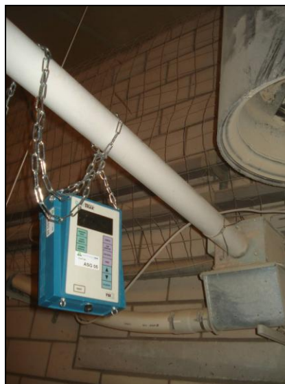
Figuur 5 Opstelling van de emissiemeting met uit- of aangeschakeld systeem: DustTrak bij de ventilatorkoker
