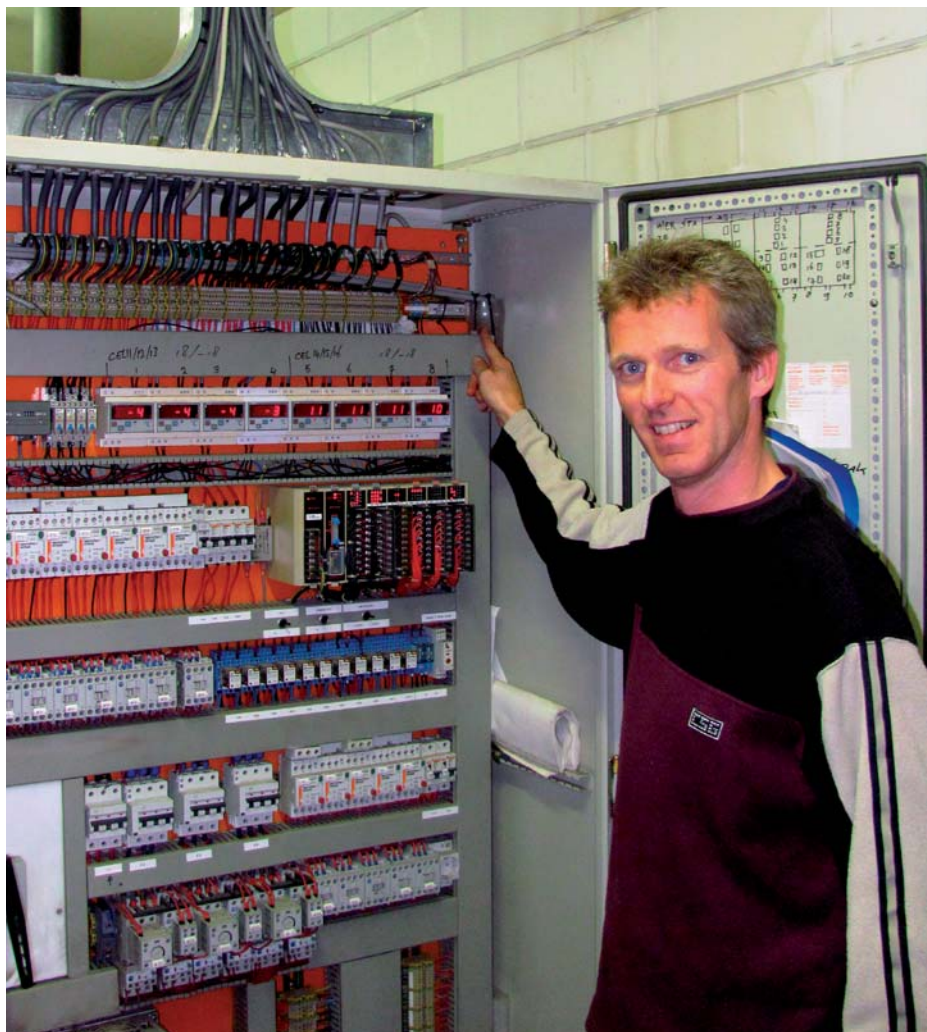
Ruud Brouwer bij een schakelkast die wordt gecontroleerd
