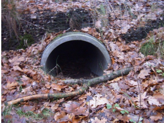
Foto 23: Betonnen rioleringsbuis (bron: www.lom.nl )
