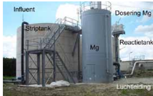
FIGUUR 4-6 ANPHOS INSTALLATIE KRUIJNINGEN
