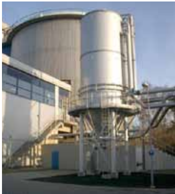
FIGUUR 4-5 AIRPEX INSTALLATIE TE RWZI MÖNCHENGLADBACH NEUWERK
