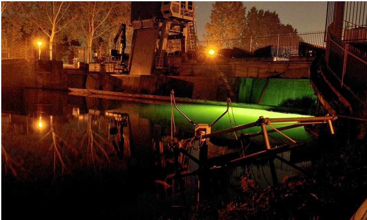
Figuur 1.1. Waterkrachtcentrale Linne met visafweersysteem (groenig licht): frame met lampenbuizen met daarin stroboscooplampen met ledverlichting. Op de voorgrond het frame met daaraan de DIDSON bevestigd.
