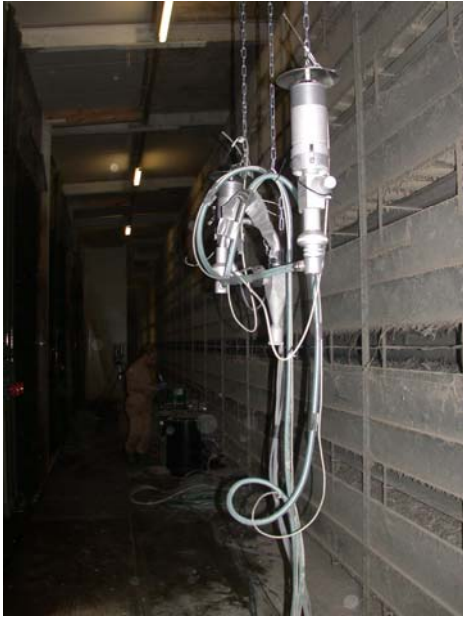
Meetpunt A, uitgaande lucht droogtunnel (rechts zichtbaar op de foto) ofwel ingaande lucht van de waterwasser. Opstelling hangt aan het plafond, meting van de lucht aan de bovenkant van de wasser.
