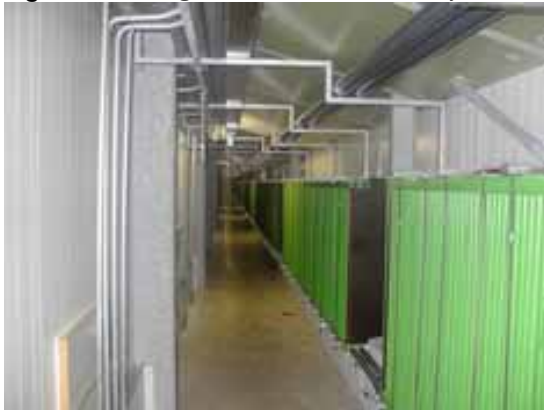
Figuur 13 Gang met warmtewisselaar bij het TerraSea-systeem
