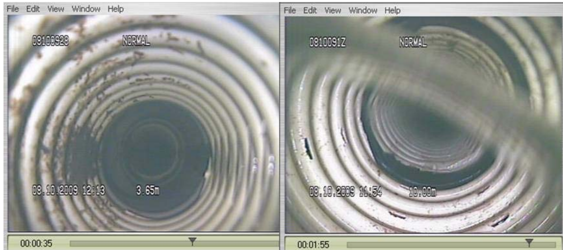
Figuur 4. Inspectie van zuigdrains door middel van miniatuur videocamera op proeflocatie Ospel; aansluiting met verzameldrain oftewel 'collector'; drain volledig met water gevuld (links); drain halfvol water met aansluiting tussen twee buissegmenten via zogenoemde klikmof (rechts)
