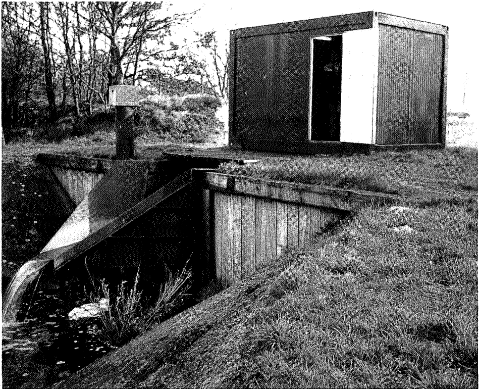
Figuur 7 H-flume in de Hupselse Beek, na de beekverbetering. In de container bevindt zich apparatuur voor het automatisch nemen van watermonsters
