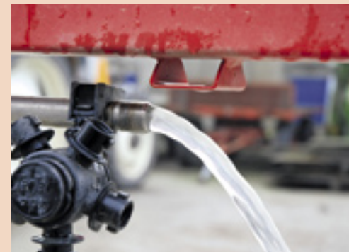
▲ Wanneer alle einddoppen van de sectieleidingen zijn verwijderd, kun je de leidingen doorspoelen. Daarna is het belangrijk dat alle leidingdelen en sectieafsluiters leeg zijn. Wanneer dit met de pomp van de spuitmachine niet is gelukt, kun je de leidingen ook leegblazen met perslucht.
