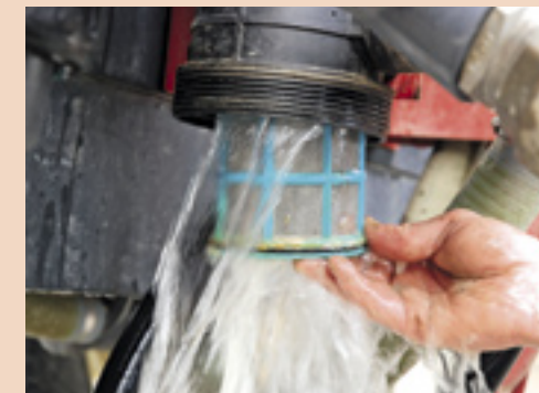
▲ In de filters blijft vaak water achter dat schade zou kunnen veroorzaken bij vorst. Dit water moet je dus verwijderen. Daarnaast moeten de filters aan het eind van het seizoen nog een extra schoonmaakbeurt krijgen. En ook hier geldt: controleer de filters tegelijkertijd op beschadigingen.
