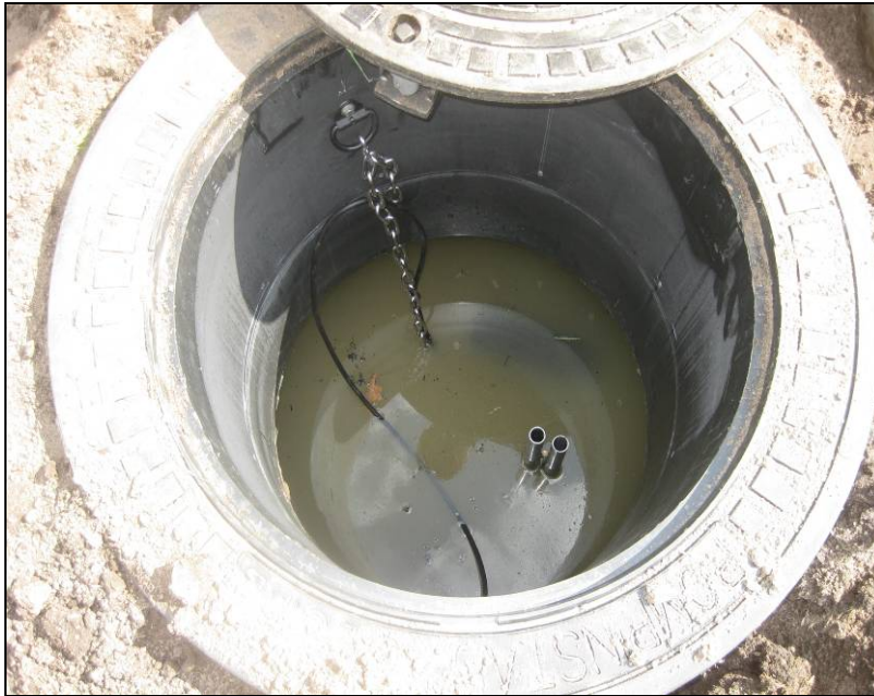
Afbeelding 3.5: Pompput waar vanuit het opgevangen drainagewater richting de sloot wordt gepompt
