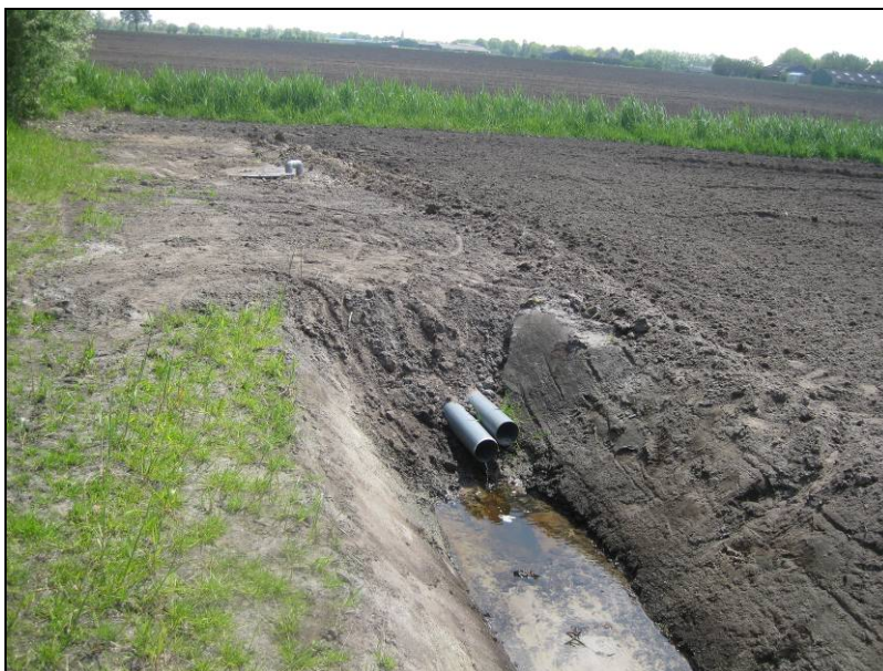
Afbeelding 3.6: Afvoer vanuit de pompput naar de nieuwe sloot (onderste pijp is de normale afvoer vanaf de pomp. De bovenste pijp is de bypass wanneer de pomp uitvalt en water de stroomvoorziening dreigt binnen te lopen)
