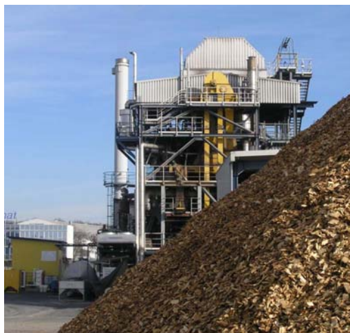
Figuur 6: Biomassavergassingsinstallatie in Güssing, Oostenrijk (8 MW).
