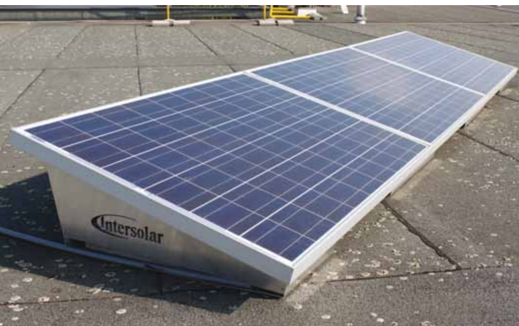
Opstelling van kristallijne PV-panelen.
