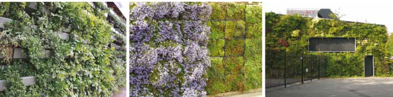
Afbeelding 5 Praktijkvoorbeeld van bovengenoemde living-wallsystemen (a) op basis van plantenbakken (Greenwave systems), (b) LWS op basis van schuimsubstraat (Fytowall), (c) LWS op basis van vitlagen (Copijn landschaparchitecten).
