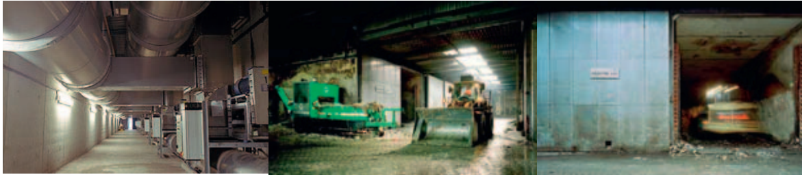
Figuur 9. Droge vergistingsinstallatie van Orgaworld in Lelystad.
