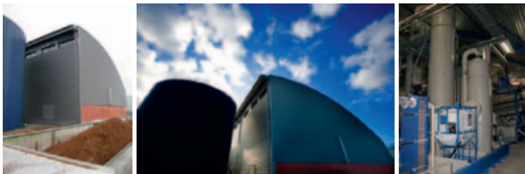
Figuur 11. Impressie van de houtstookinstallatie en CO 2 scheiding bij Vink Sion B.V.
