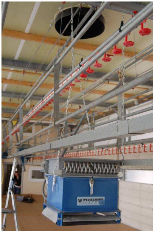
Figuur 3 Opstelling inlaatventiel en verwarmingsinstallatie.
