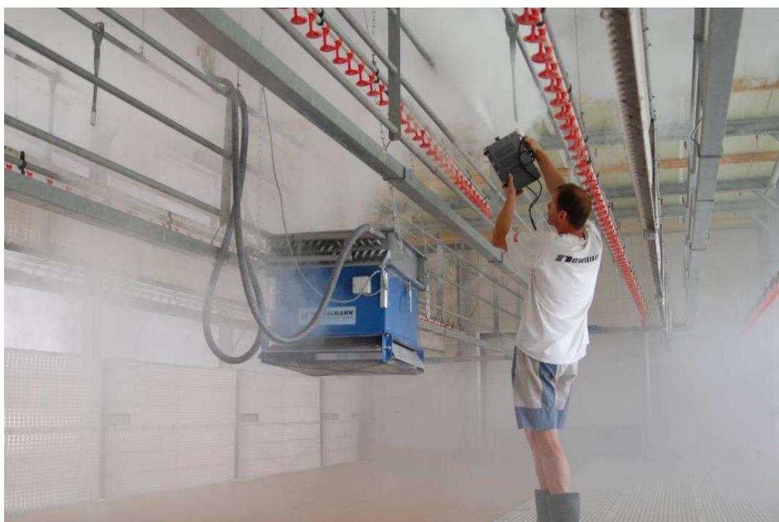
Foto 4 Het verwarmingssysteem blaast de aangezogen lucht uit de inlaatventielen in vier richtingen over de kuikens.
