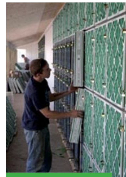
Grove voorfilters aan buitenzijde
