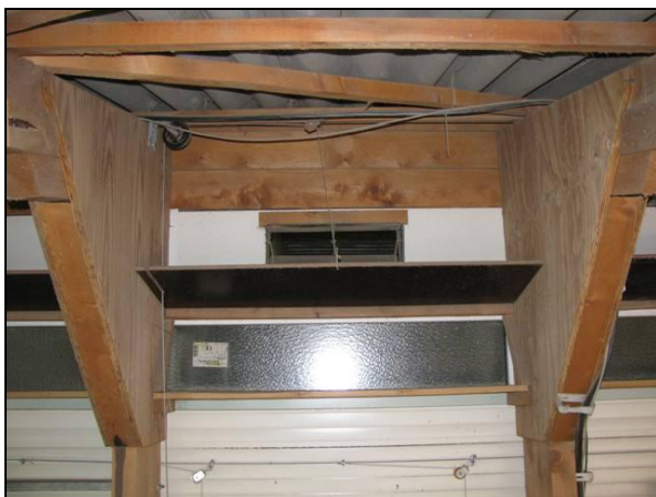
Inlaat in zijgevel tussen stal en wintergarten
