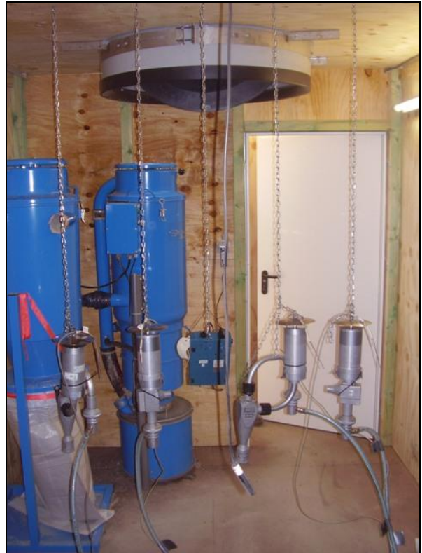
Meting ingaande lucht (in duplo), met daarachter de stofzuiginstallatie
