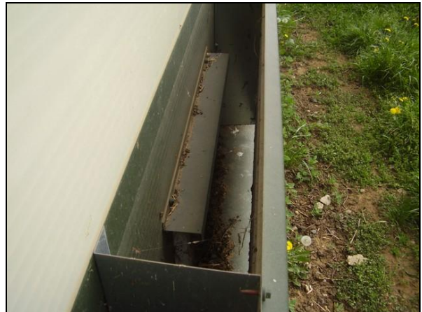
Inlaatventiel achter winddrukcap zijgevel stal
