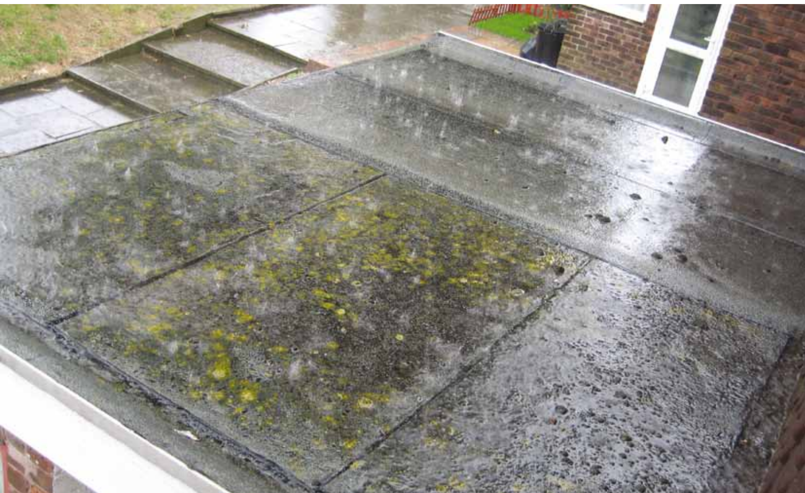
Bitumen daken kunnen olieachtige substanties afgeven.
