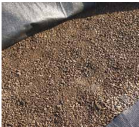
Nadat het worteldoek op de lava is aangebracht, wordt twee keer aangetrild.
