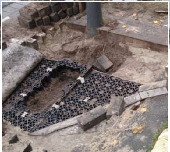
Het uitlichten van één element is bijna niet te doen. Er is daarom een deel van een permavoidelement uit gebroken.
