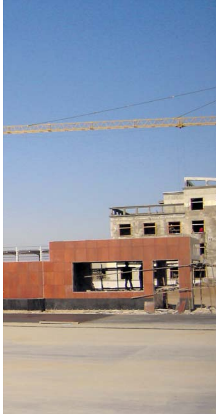
Boven: De bouw van de woningen voor werknemers bij de entree van het fabrieksterrein in oktober. Links onder: Het transport vindt plaats met ezelkarren. Midden onder links: Twee aardappelopslagloodsen zijn al gereed. Midden onder rechts: Het rooien gebeurt met de hand. Rechts onder: Aardappelteelt vindt plaats op kleine percelen.
