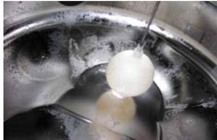
Voorbeeld van aanslag in de luchtafscheider, zichtbaar na opening van het deksel.
