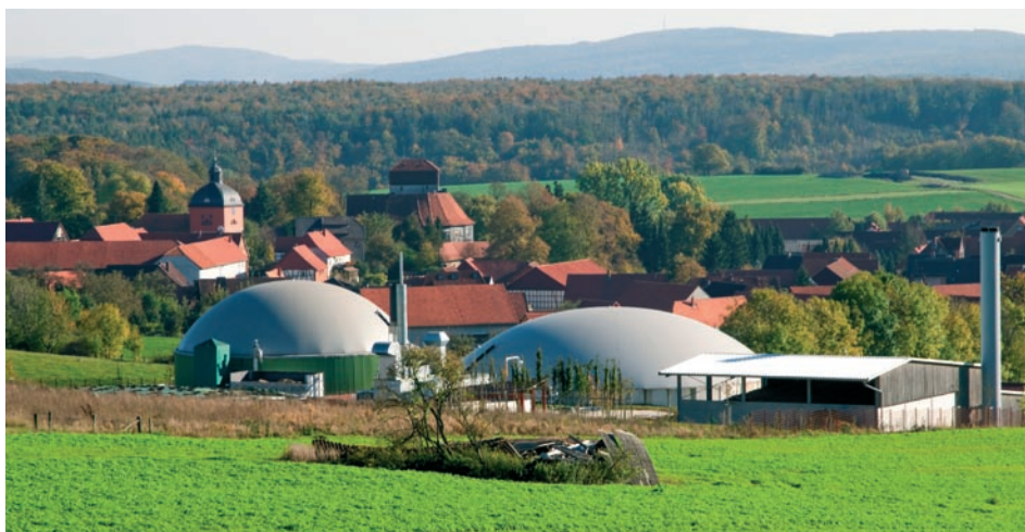
Een warmtekrachtcentrale op bioenergie (o.a. uit mest) in het Duitse Jühnde voorziet het hele dorp van warmte en stroom.
