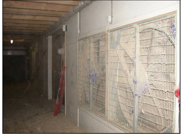
Binnenzijde ventilatoren in de achtergevel
