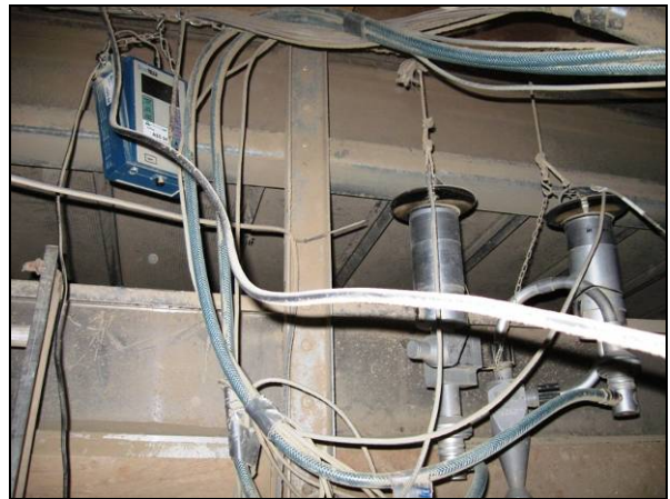
Meetpositie ingaande lucht van de droogtunnel (hoog, platen 1 en 2) in de drukkamer
