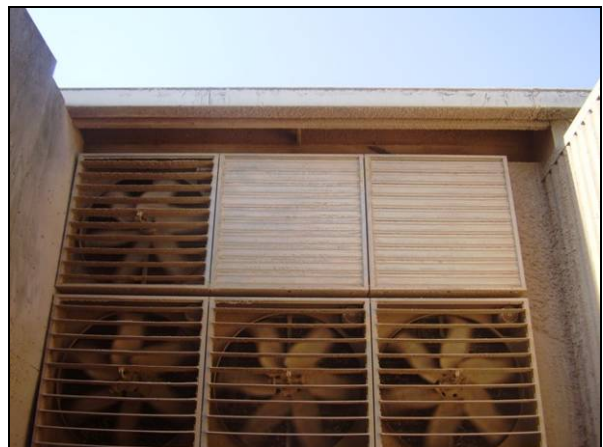
Groep van 9 bypassventilatoren (6 zichtbaar)
