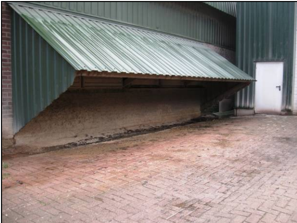
Bypass ventilatoren (5x) in zijgevel stal 1
