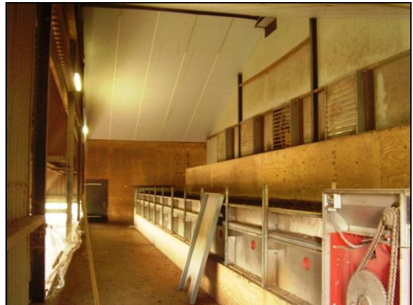
Droogtunnel met 4 bypassventilatoren (boven)
