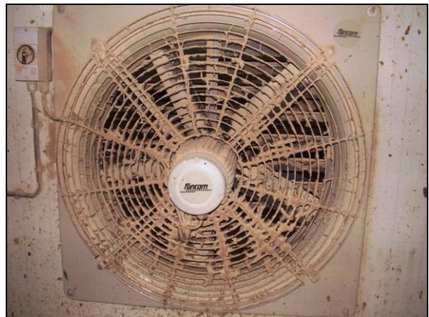
Drukventilator in achtergevel naar drukkamer
