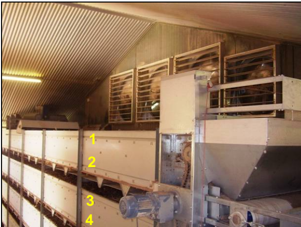
Groep van 4 bypassventilatoren (eerste etage) De eerste vier mestbanden zijn geel genummerd
