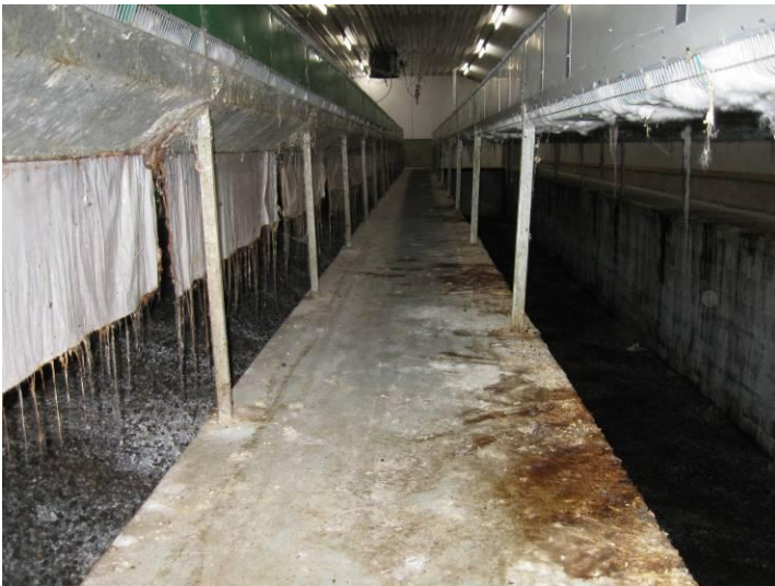
Mestopslagen onder de hokken, boven is het gaatjes-plafond zichtbaar met achterin één van de drie ventilatiekokers
