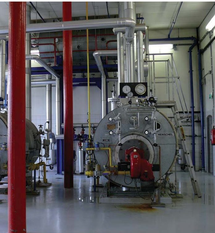
Vrijgekomen warmte bij compressoren kan worden gebruikt om water voor stoomketels voor te verwarmen.
