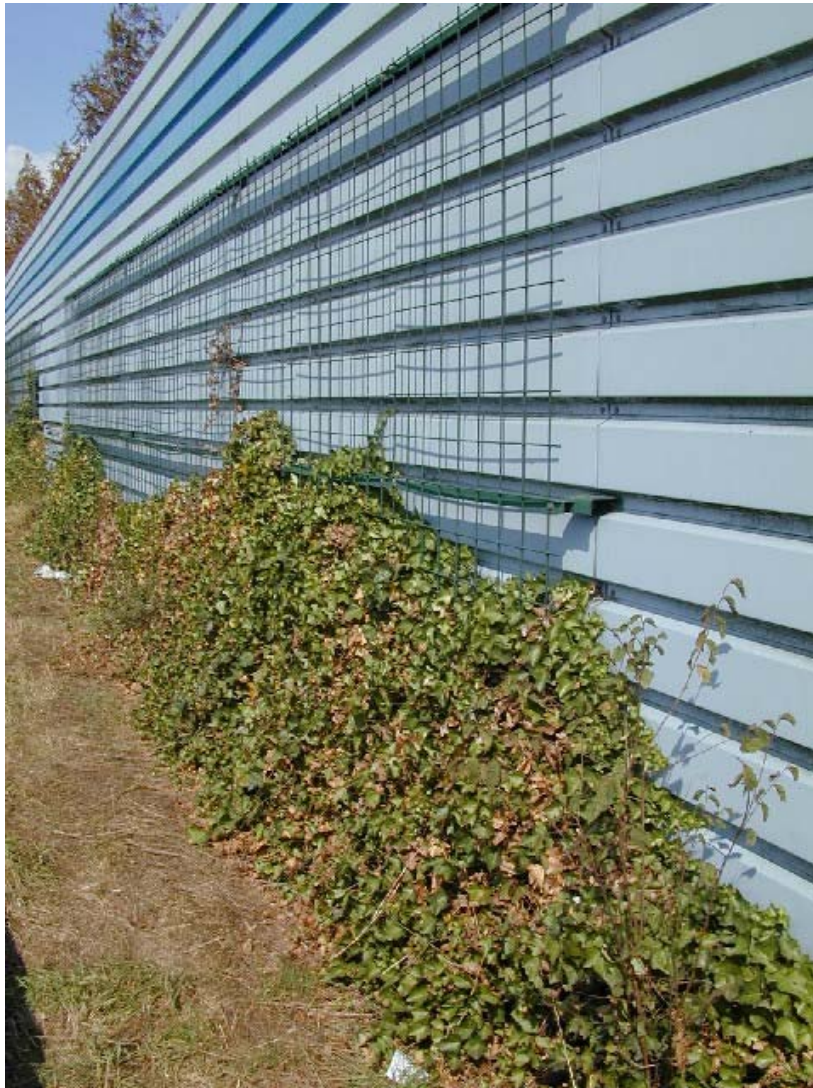
Afbeelding 6: Metalen geluidsscherm langs A27 bij Maartensdijk; platen en klimhulp beide ongeschikt voor klimop. Foto PPO
