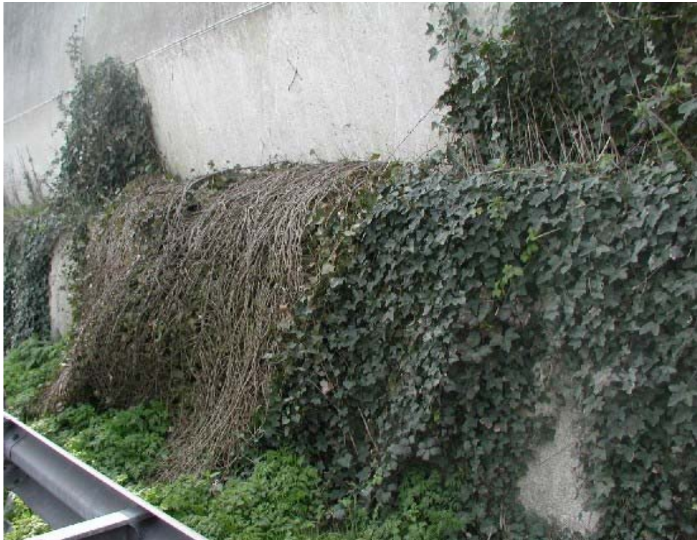
Afbeelding 16: Grote plakken klimop zijn omlaag gekomen; de toplaag van het beton zit nog aan de hechtwortels. Foto: RWS
