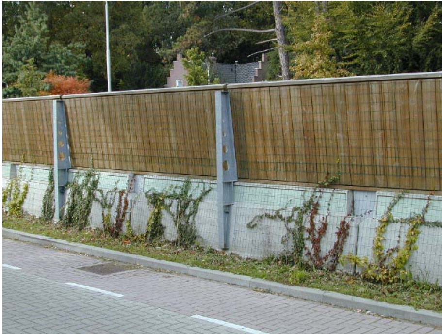
Afbeelding 6.17: Beplanting in smalle strook grond; slechte groei en gedeeltelijke sterfte van de klimop. Foto PPO
