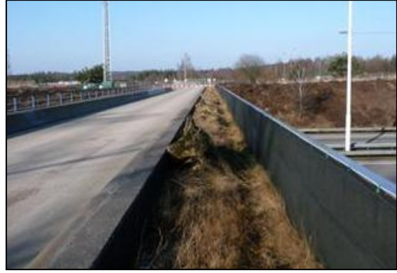
Foto 13 Groenstrook met boomstobben op viaduct Mauritskamp over rijksweg A28 nabij Soesterberg. Foto: A. Griffioen
