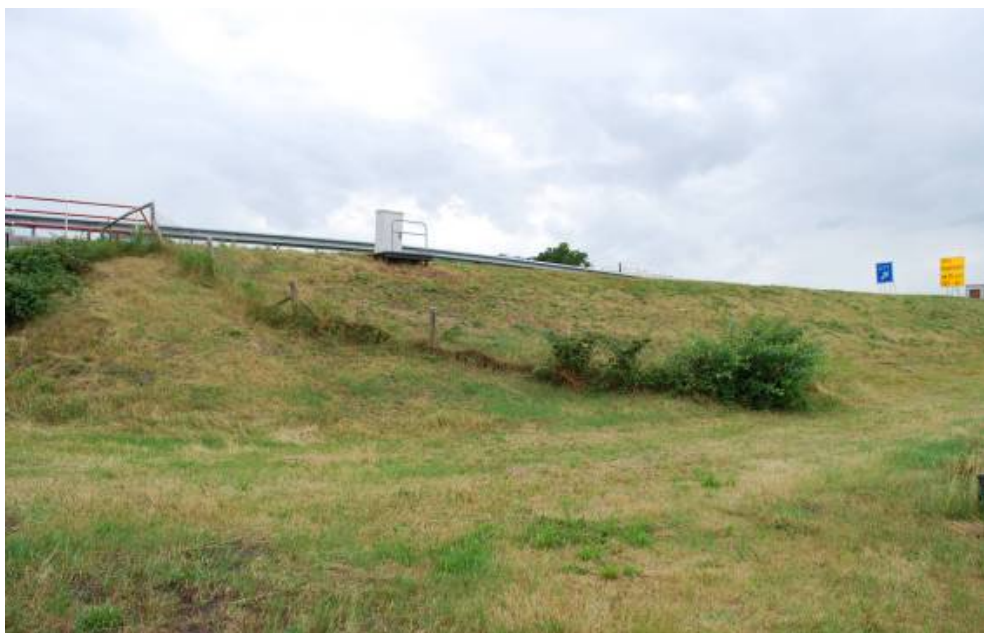
Brug A32-Kuinder of Tjonger ten zuiden van Heerenveen bij afslag 10: te kort raster.
