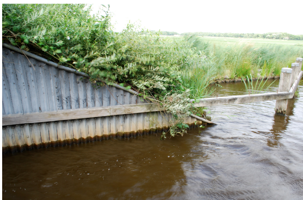
N927 onderdoorgang: geen droge loopstrook.
