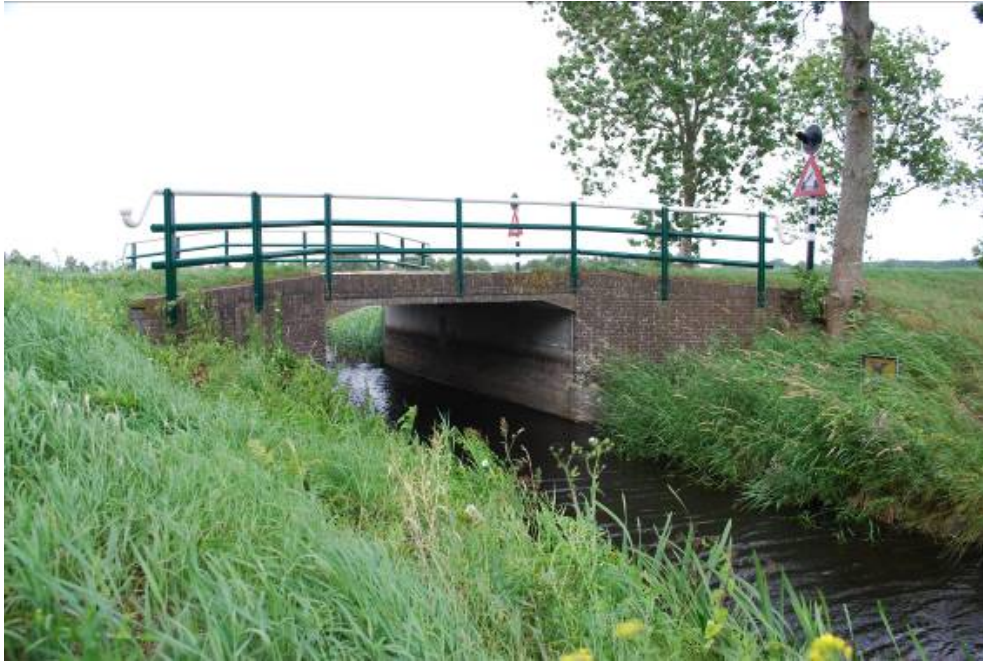
N392 brug Nieuwe of Tweede Deel: geen geleidend raster, geen droge onderdoorgang.
