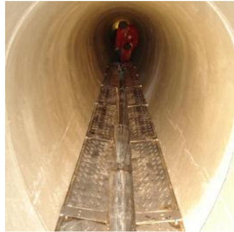
Figuur 7: Rioel warmtewisselaar Geveke
