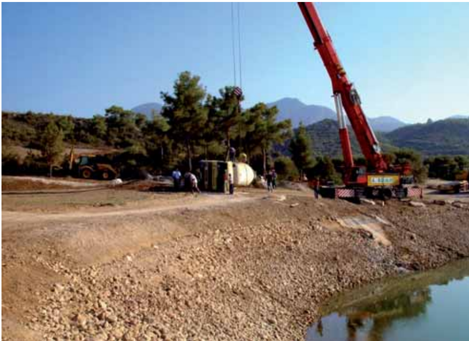
Het ongeval heeft het project niet vertraagd. De schade aan materieel van het reservoir was achteraf gezien minimaal. Slechts 300 m2 van het zeil was op bepaalde plaatsen beschadigd. Deze schade werd in één dag hersteld.
